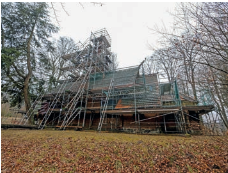
Kirche und Wald müssen beide umgebaut werden. epd-bild/Jens Schulze
